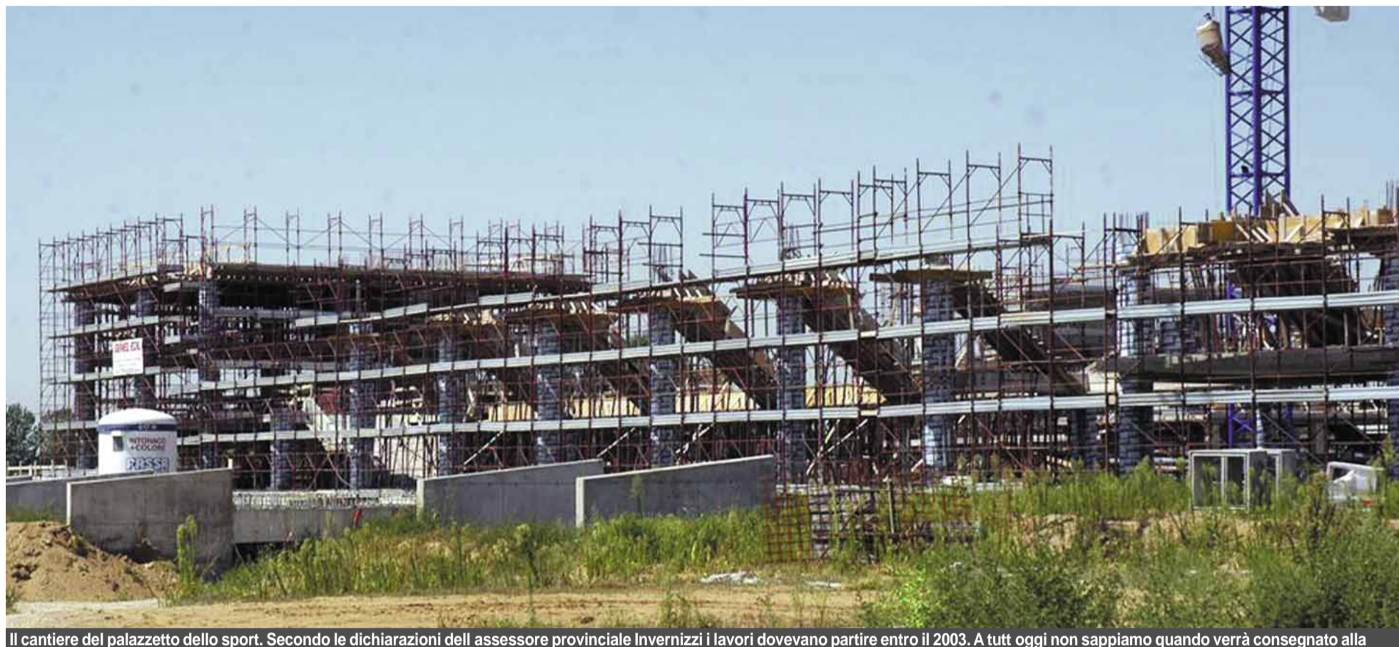
Il cantiere del palazzetto dello sport. Secondo le dichiarazioni dell'assessore provinciale Invernizzi i lavori dovevano partire entro il 2003. A tutt'oggi non sappiamo quando verrà consegnato alla
