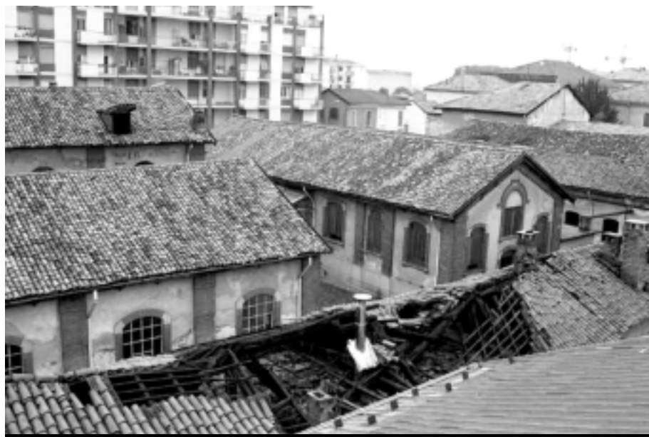
Tetti crollati e grande desolazione all'ex Macello, il grande assente nel nuovo Piano regolatore approvato nel dicembre 2004
